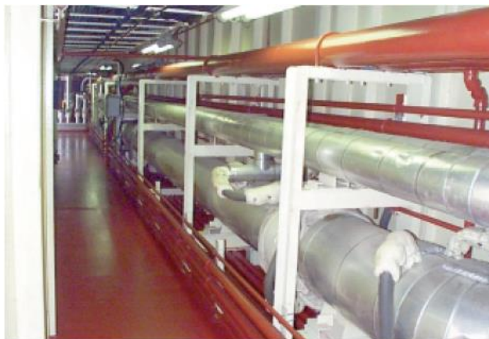
شکل (۴-۴) خط لوله عایق بندی شده انتقال گوگرد مذاب در کشتی Sulphur Enterprise مجهز به سیستم Contro Trace bolt-on
